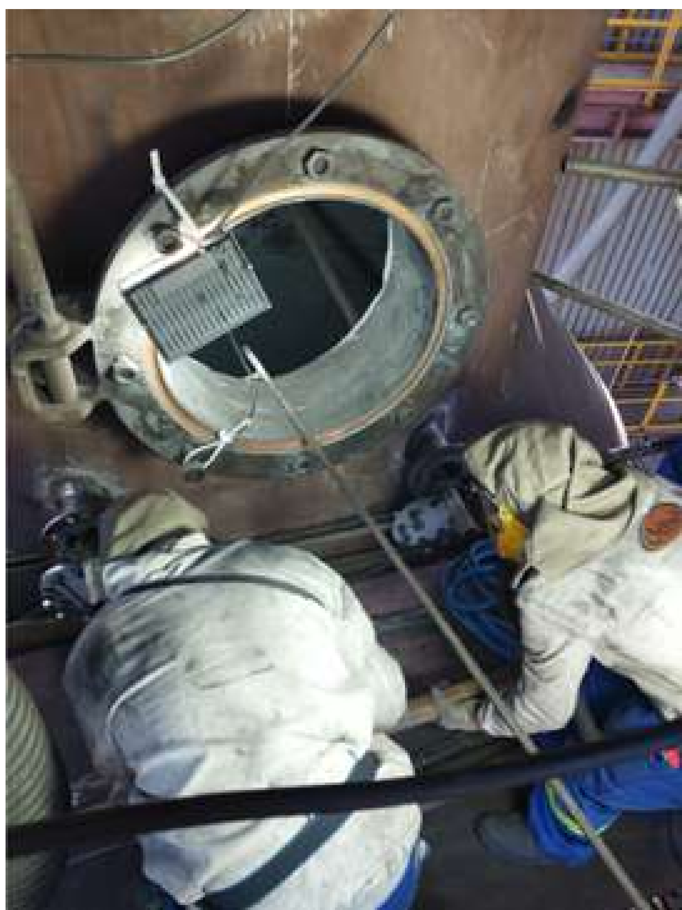
Serviços de campo - mecânica Mechanical field services
