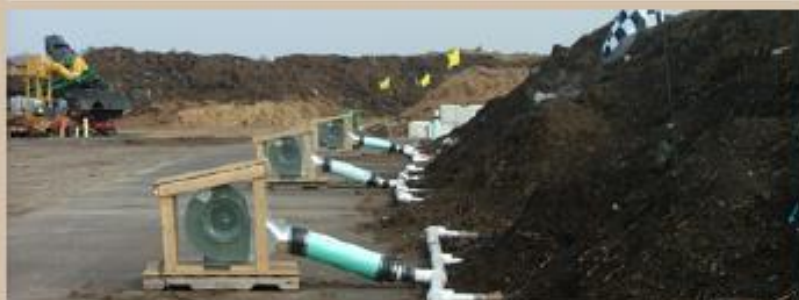
Foto 3 — Processo de compostagem utilizando sopradores de ar
